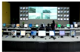
监控中心 Monitoring Center
